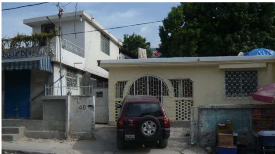
La maison à gauche porte un code rouge juste au-dessus du numéro civique, 46. Il est extrêmement dangereux d'y habiter. Photo fournie par la délégation.
